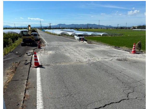
町道の変状と応急処置状況
